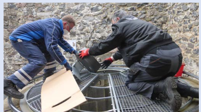
Obermonteur Rainer Eckhardt und Schlosser Roland Koch bauen die Lampe in den Brunnendeckel ein.
